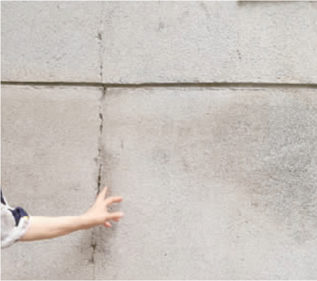
居民称墙壁裂缝越来越宽了
