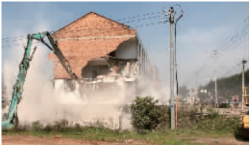
拆除工地没有喷水降尘，导致扬尘滚滚
