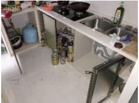
杨女士家中厨房柜门损坏严重
