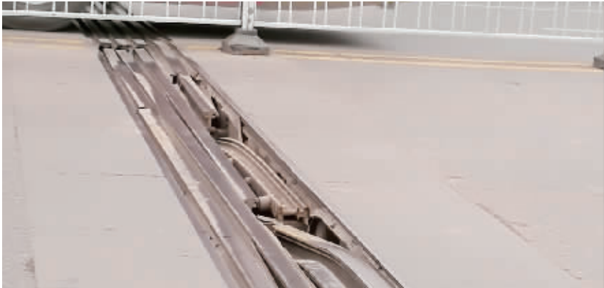
伸缩缝工字钢被碾压成麻花状
