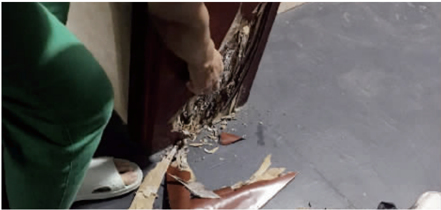
邹先生家地下室的门框遭到白蚁蛀食
