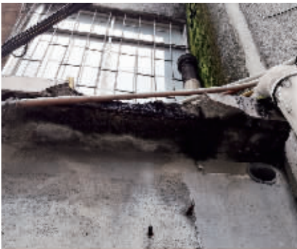
屋顶瓷砖老化脱落
