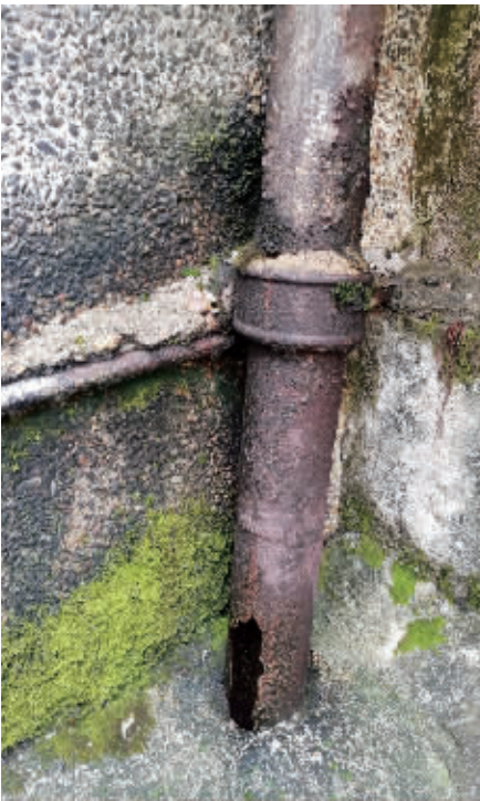
下水管道锈蚀破损
