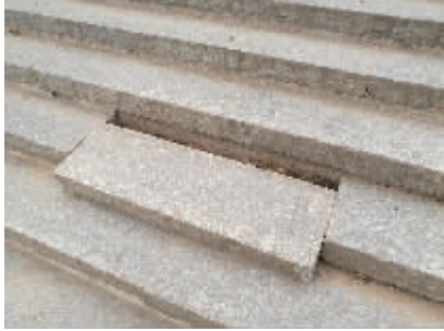
石块已松动脱落
