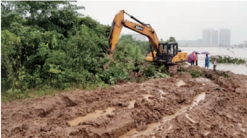
2日下午6时，幸福河与湘江交汇处，水位持续上涨，地势较低处已被淹，一处堤岸出现险情，将危及附近百余名群众的安全。下午4点开始，白沙洲工业园区组织街道村组干部全力抢险，紧急撤离附近居民。
