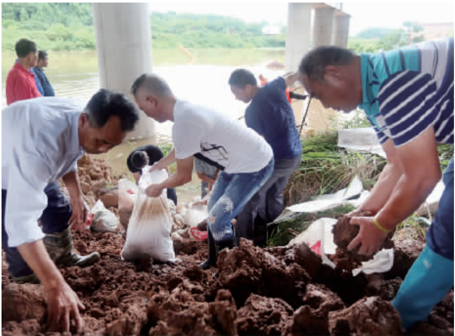
呆鹰岭镇杉旭河新民村黄美洲段涵闸拍门损坏,导致河水倒灌,区防汛部门组织人员抢险。
