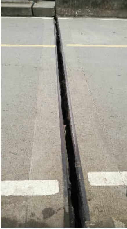
桥梁交通标线发生了错位现象
