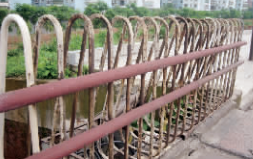
成排锈蚀的护栏杆已经断裂。
