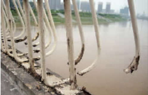
护栏锈蚀严重。
