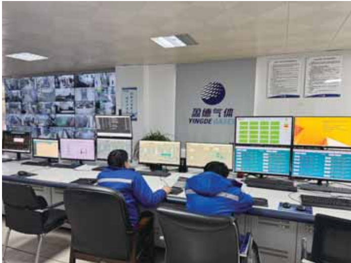
衡阳盈德气体有限公司中控室。
