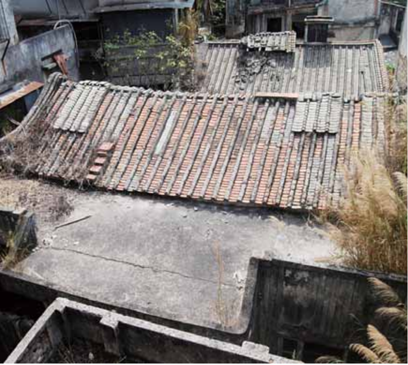
中央红色交通线旧址(汕头站)修复前的屋顶。图片由汕头市金平区文化馆提供
