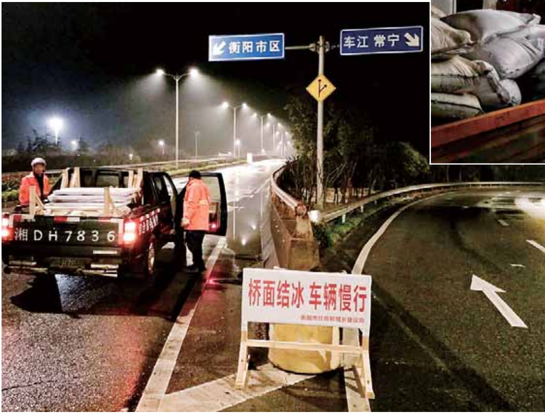
在易结冰桥梁设置提示牌
