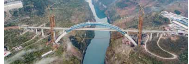
这是3月14日拍摄的鸭池河特大桥（无人机拍摄）。目前，成贵高铁控制性工程鸭池河特大桥建设已进入最后冲刺阶段，大桥主体工程完工，钢轨铺设已经完成。预计该桥将于年内竣工。 ■新华社发
