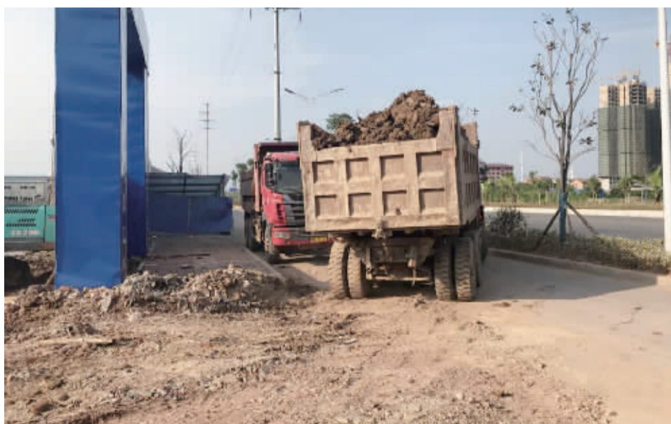
运输渣土车辆存在无遮盖、无车牌、无清洗等问题
