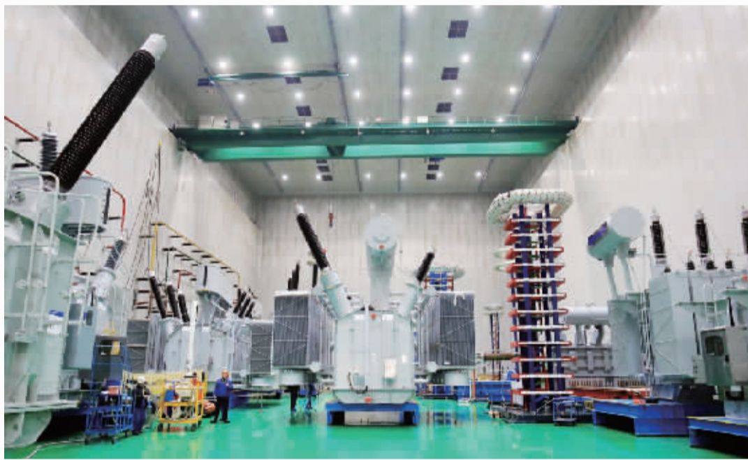
特变电工 750V 试验大厅
