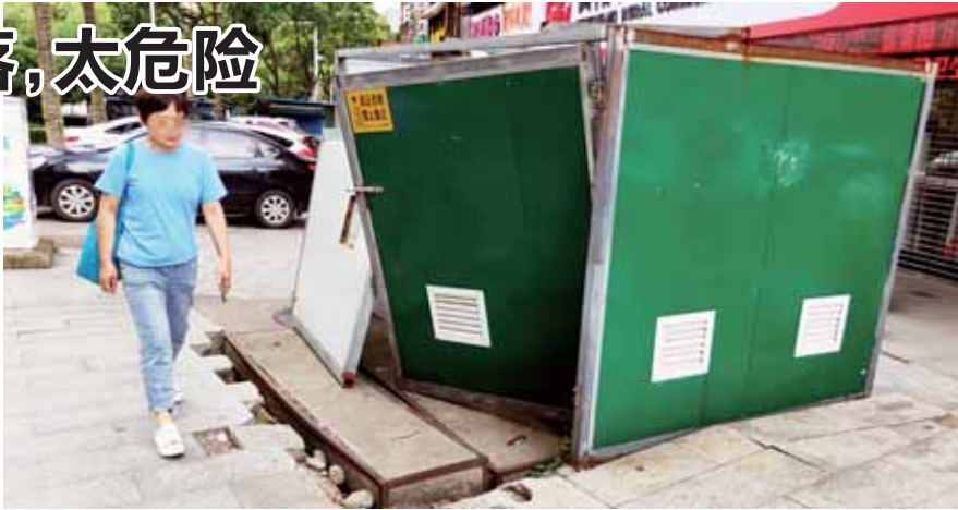
路人经过脱落箱门的变压器
