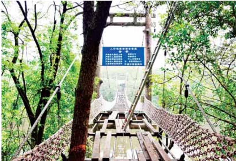
桥面木质板已腐朽老化
