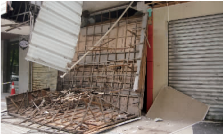
门头轰然坍塌,惊吓到了路人
